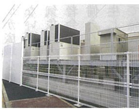
清須市の市立桃栄小学校の体育館に設置されたGHP室外機と非常用発電機
